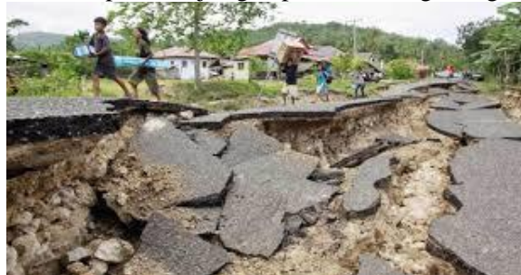
Gambar 4. Kerusakan Lingkungan Akibat Gempa Bumi (Sumber: http://www.beritadaerah.com )
